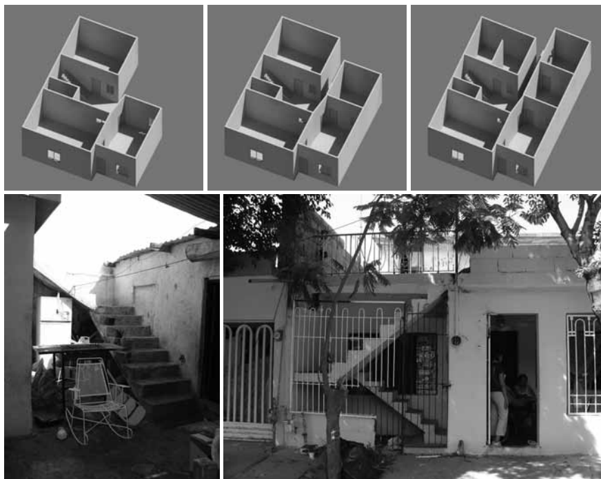
Figura 45. Expansión de la casa mostrando formación de espacios "muertos". Fotos inferiores: espacio muerto bajo las escaleras.
