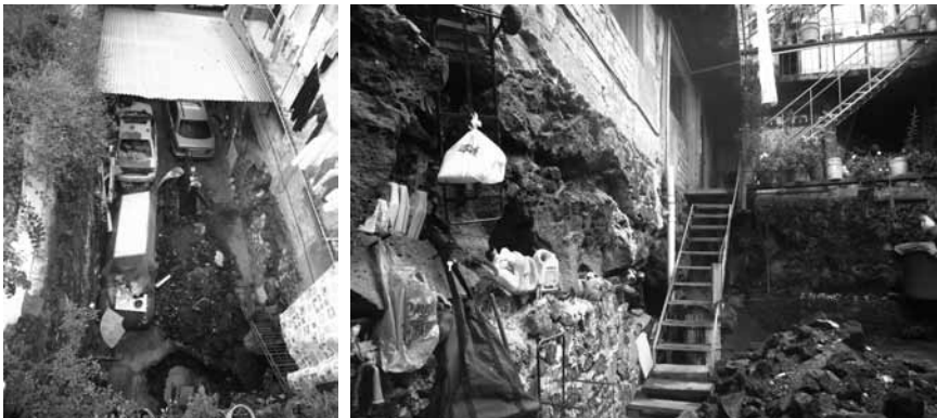
Figura 1. Dilapidación física en colonias populares.
